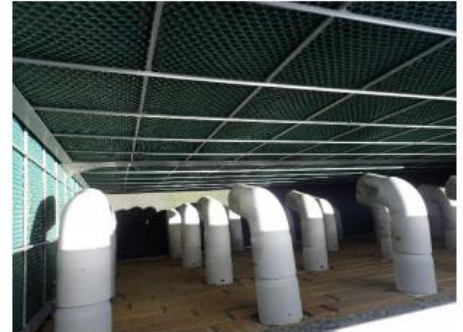
Støjafskærmning ved ventilationshuller
