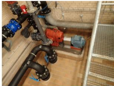
Beluftning af filtre
