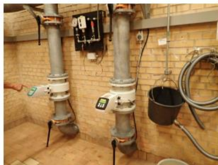
Vandmålere på de 2 afgange fra Vandværk
