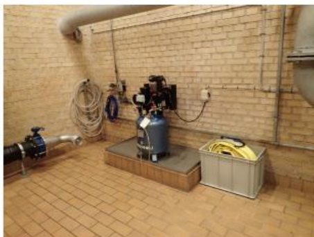
Kompressor til ventiler
