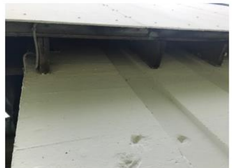
Støjafskærmning på iltningstårn
