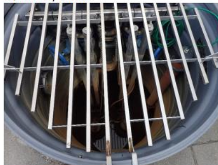
Brønd til skyllevand
