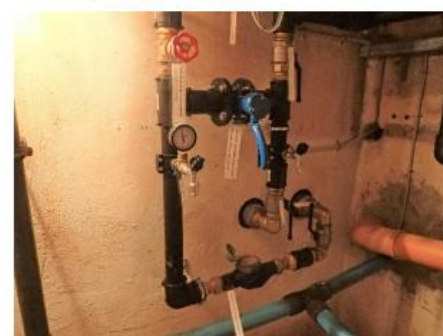
Rørføring med skiltning
