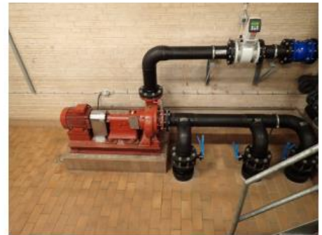
Skyllevandspumpe med måler
