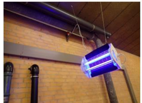
Insektlampe i filterbygning
